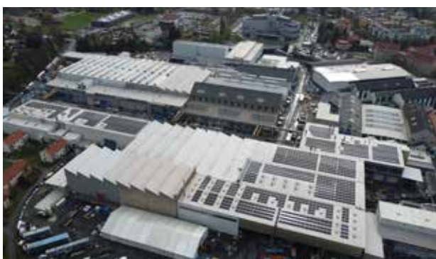
1. Teil der Photovoltaikanlage mit 1.065 kWp Leistung (Foto: andritz.com)
