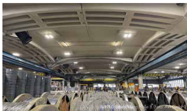
AVI LED Beleuchtung Halle B (Foto: AVI GmbH)
