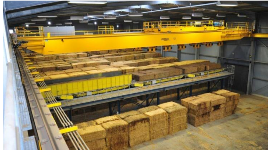
Bild: Stroh-HKW Emsland Emlichheim
