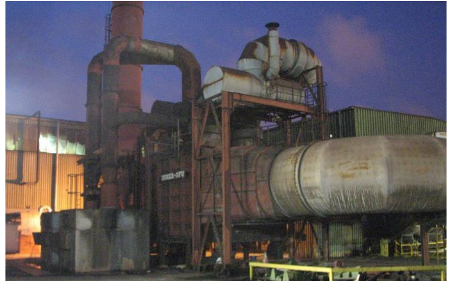
Abgasnutzung Wiedererwärmungofen Arcelor Mittal Quelle: AMHH
