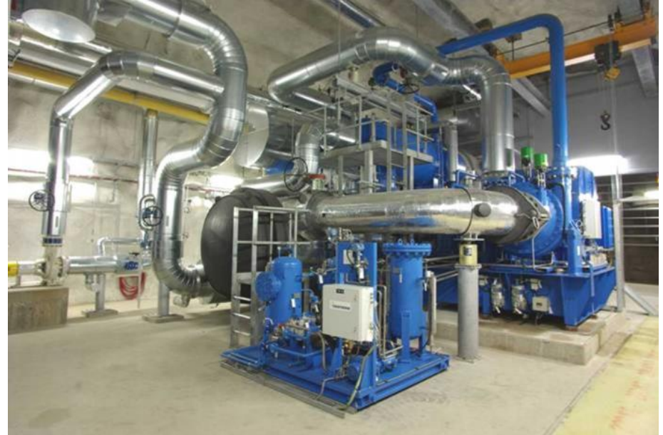
Meerwasser-Wärmepumpe Fernwärmeversorgung Helsinki Quelle: www.friotherm.de
